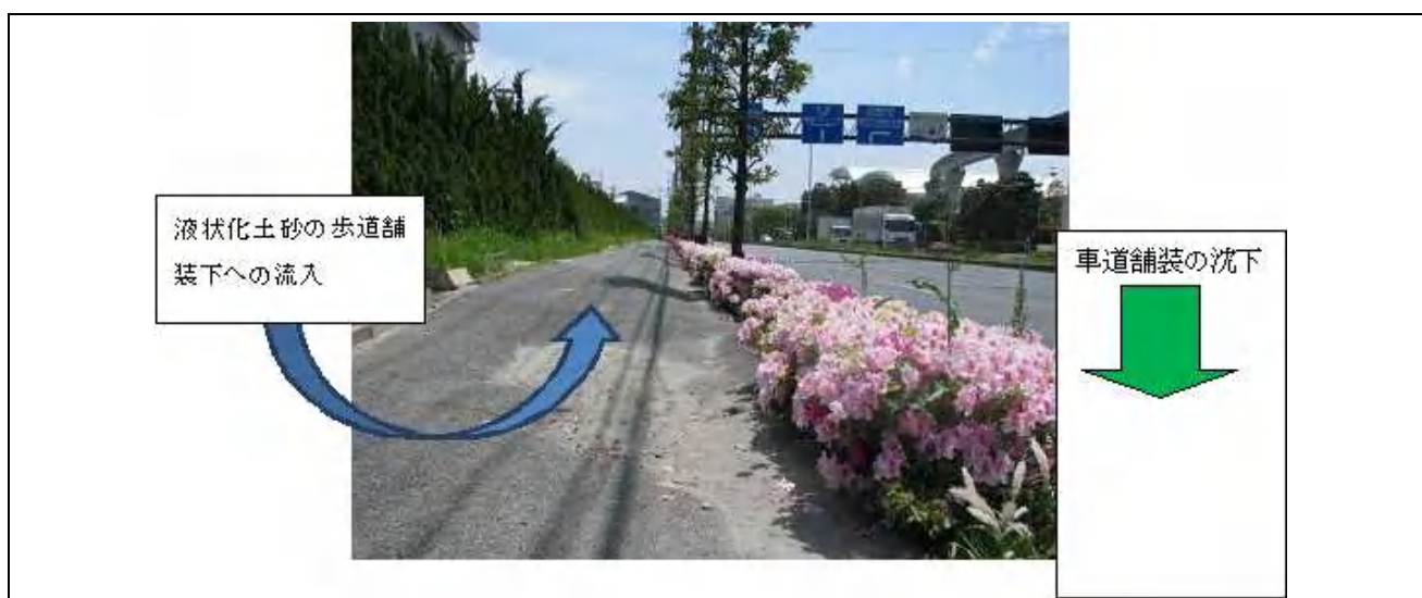
図 3- 7 k11 付近 大規模平面駐車場に隣接駐車場側から歩道舗装下に土砂が流入
