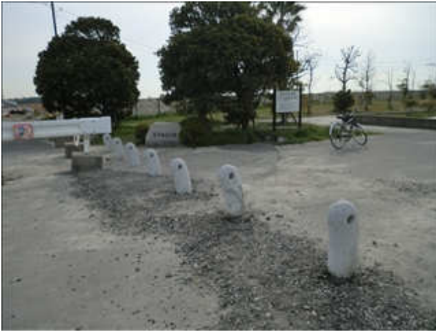
公園境が破壊され車止めがゆがんでいる。
