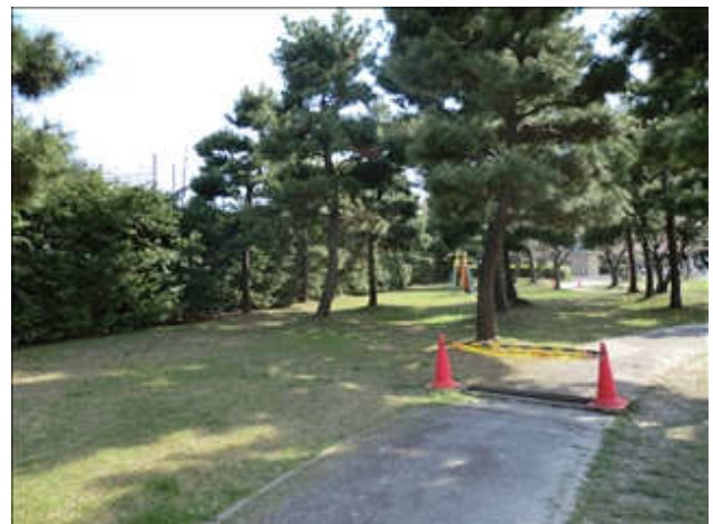
排水路の蓋が落ちている。
