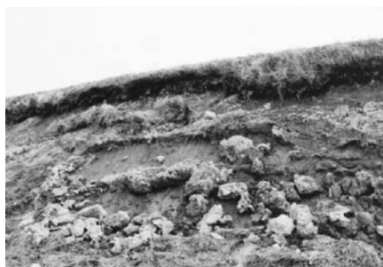
写真-2 法肩の亀裂から崩壊した法面
