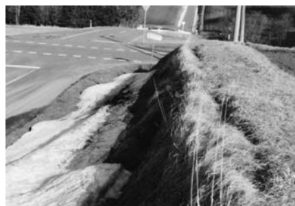
写真-1 春先に生じる法肩の亀裂
