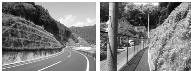
写真-1 GT フレーム工法の適用例 (左: 道路造成工事, 右: 狭隘地における施工例)
